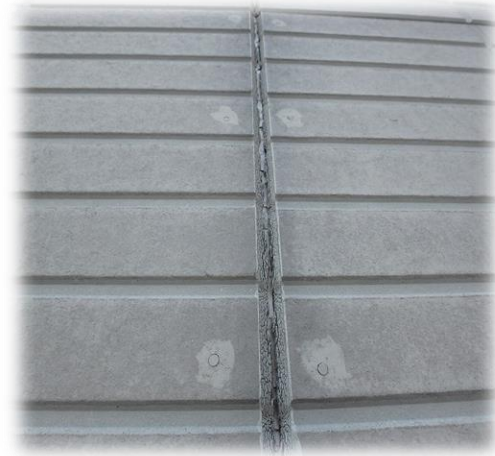
コーキングの劣化
